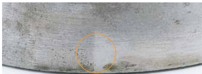
分体式轴承座结合处造成的轴承外圈应力集中点上的 局部剥落 。
