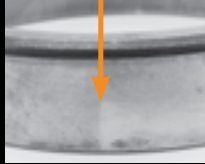
İki parçalı yataklarda yatak birleşim noktasındaki çap farkının etkisi ile oluşan iz
