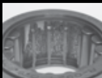
Ecaillage dû à la concentration de contraintes géométriques (GSC) sur la bague extérieure
