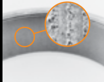
Canelare datorată arcului electric
