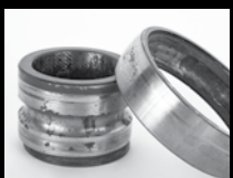
严重腐蚀和浸蚀
