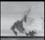
Точечный поверхностный дефект (выкрашивание)
