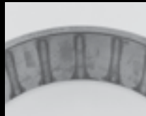
Manchas de agua en la pista de rodadura externa
